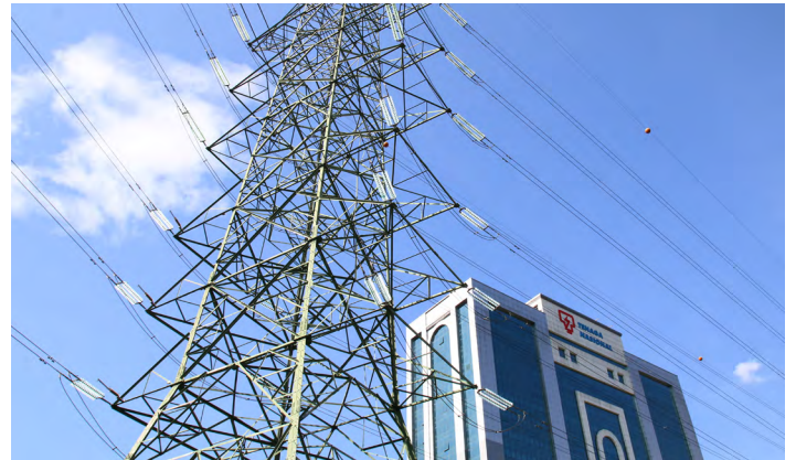
► Menara penghantaran bekalan elektrik Tenaga Nasional Berhad
